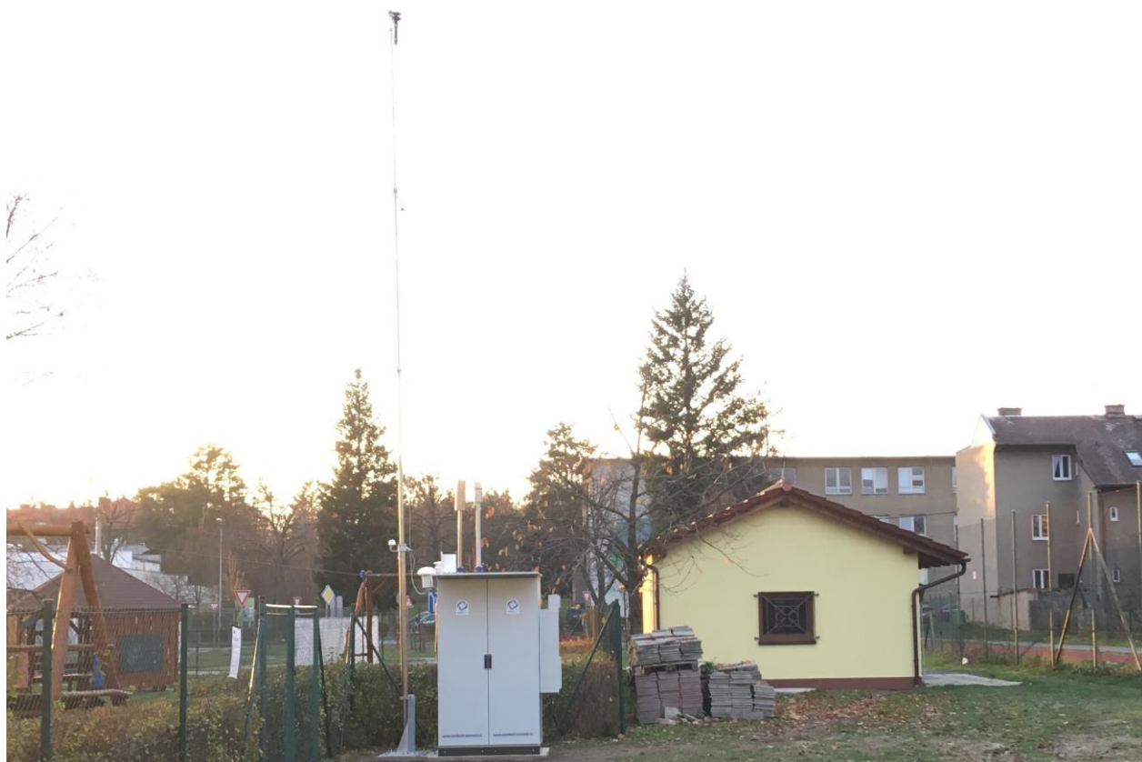
Obr. 1: Měřicí stanice kvality ovzduší v lokalitě Hranice
